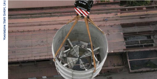
Fackelkopf mit Drallapparat und Zündbrennern
